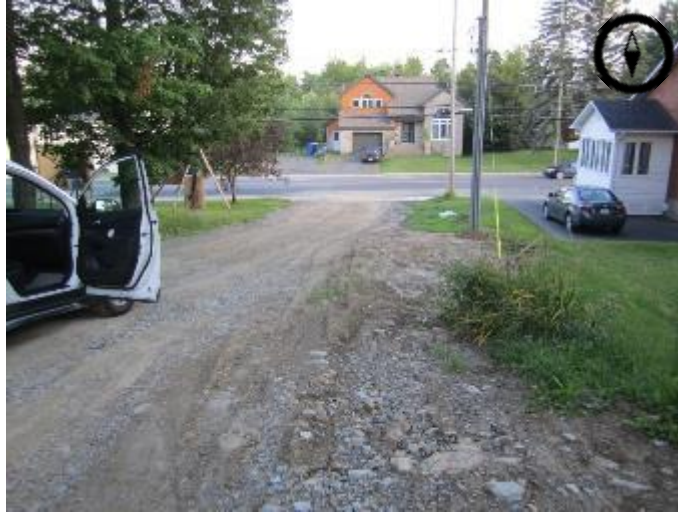
Photo 12 : Crevasses présentes dans l'entrée du stationnement du complexe résidentiel
