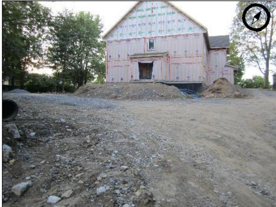
Figure 3 : Vue du stationnement adjacent à la rue Lewis O vers le condo en construction (Source: InnoVert Design, 8 août 2017, 18h45)
