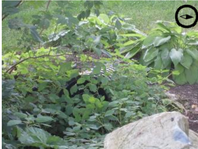
Photo 4 : Tuyau de drainage à proximité du lac
